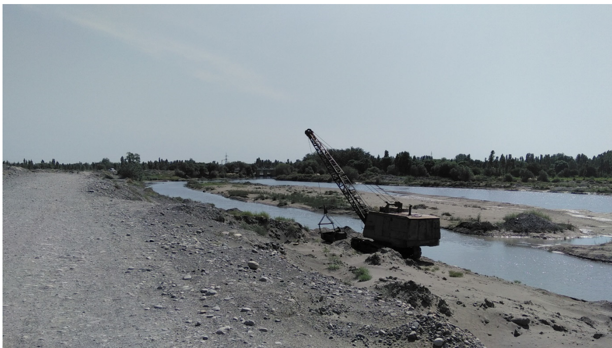
Obr. 4.7 Melioračná nádrž na zachytenie sedimentov (Foto: Kaletová)
