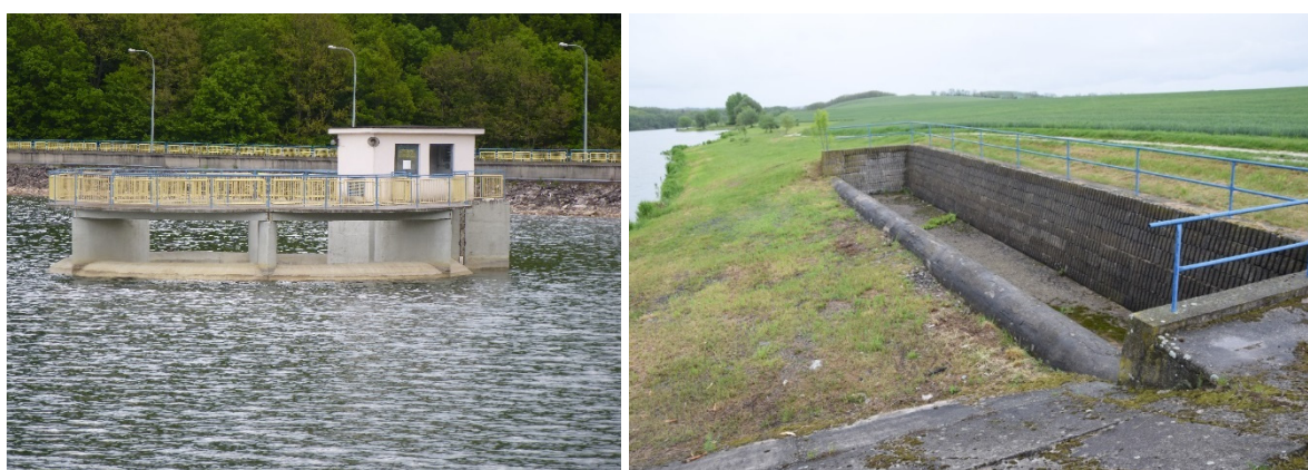
Obr. 4.14 Šachtový (vľavo) a bočný (vpravo) bezpečnostný priepad (Foto: Kaletová)
