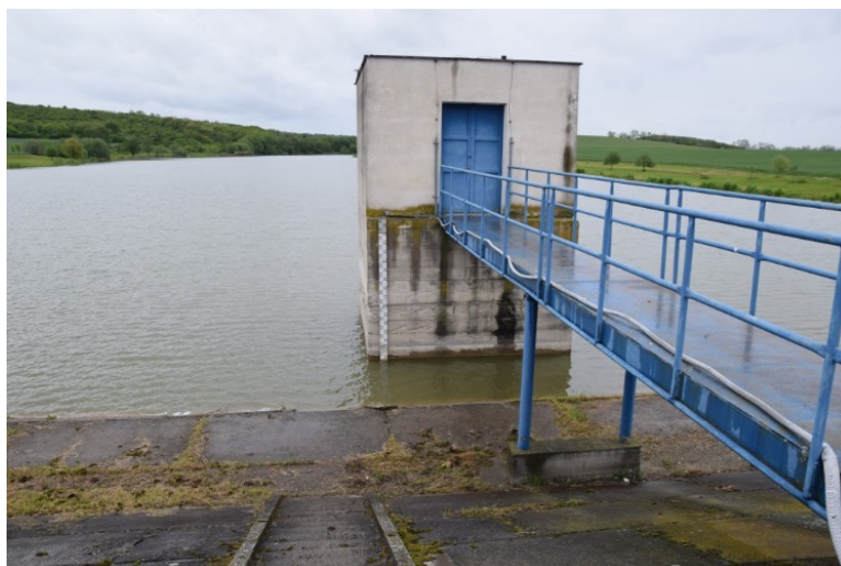
Obr. 4.13 Výpustný objekt na malej vodnej nádrži (Foto: Kaletová)
